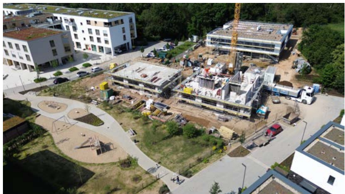
Die Kita und sechs Reihenhäuser befinden sich in Norf derzeit im Bau.
